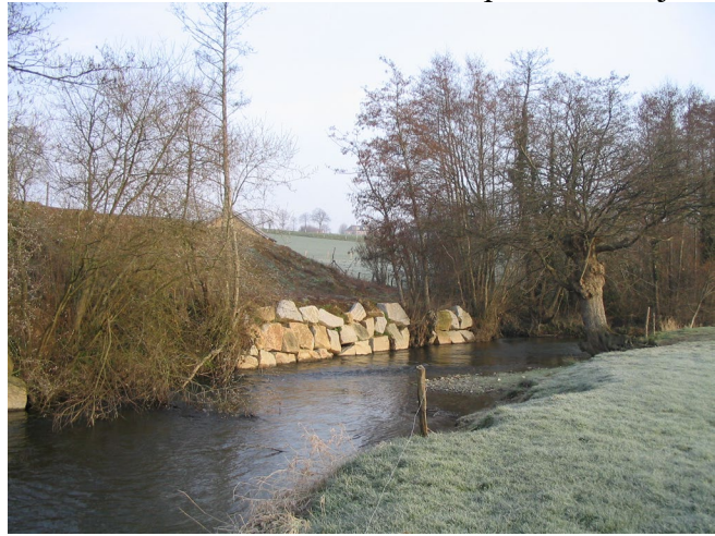
Figure 5 : enrochement de réparation (Vernix- juillet 2004)
